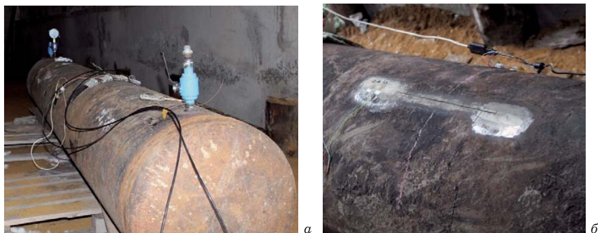
Рис. 2. Фрагмент трубы диаметром 530 мм (а) и вид продольного надреза на трубе при гидравлическом испытании (б)
